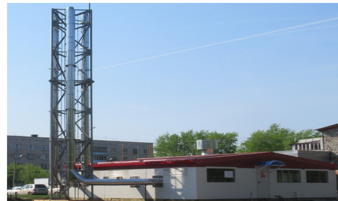
ООО «УК «ТЕПЛОКОМПЛЕКС» Котельная пос. Первомайский (2019г.)
